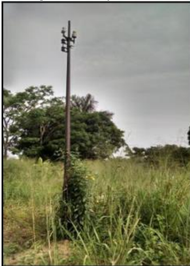
Figura 13: Poste Telegráfico na Vila Tabajara em Machadinho do Oeste, RO
