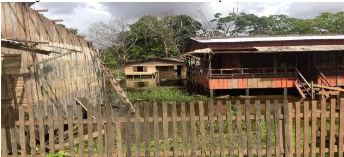
Figura 7 – Foto Casa destruída na cheia de 2014 que se mantém desabitada
